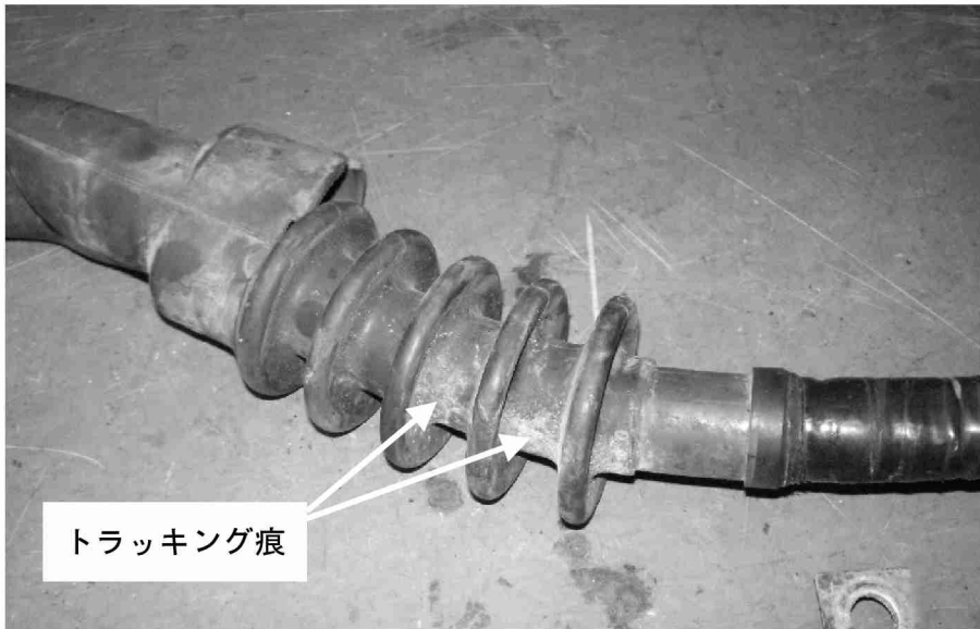
写真2 ゴムとう管のトラッキング痕
